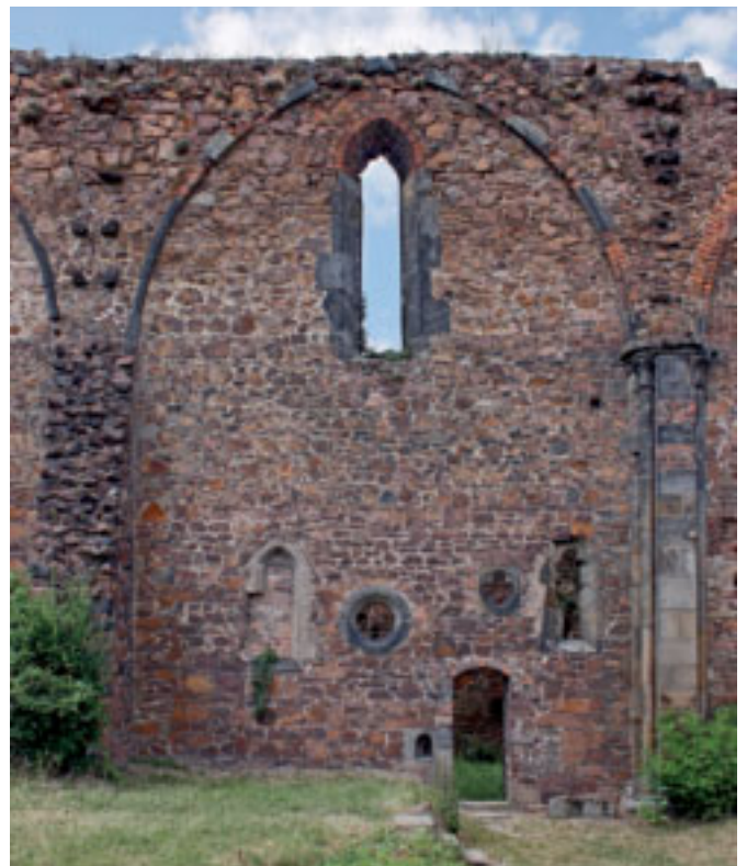
Blick auf die Abrisskante der ehemaligem Einwölbung
